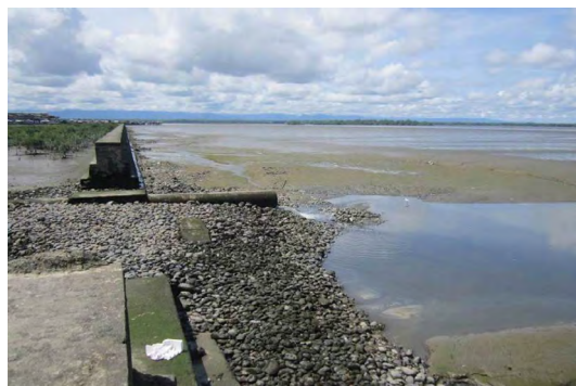
Figura 6. Contaminación de la zona de bajamar por emisor ubicado en “playa basura”.
